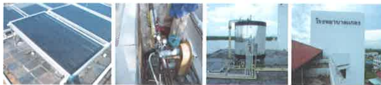
รูปที่ 21: ระบบน้ำร้อนพลังงานแสงอาทิตย์แบบผสมผสานที่โรงพยาบาลกลาง (พพ., 2550).
