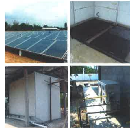
รูปที่ 17: ระบบผลิตความร้อนพลังงานแสงอาทิตย์ ที่โรงอบยางพาราแผ่นรมควัน (พพ., 2551)
